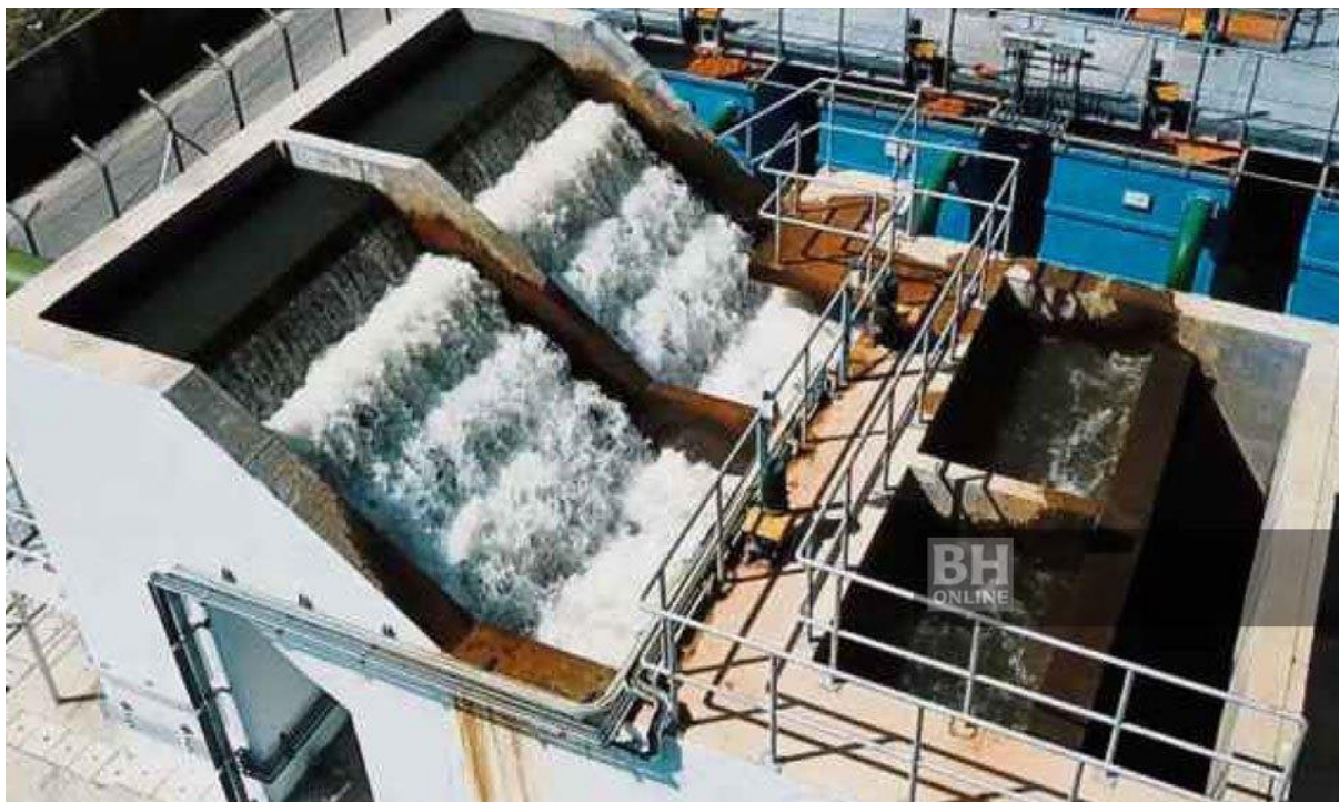
Loji Rawatan Air Losong aset penting bagi memenuhi permintaan air yang semakin meningkat dengan jaminan kualiti air yang bersih serta selamat digunakan.
