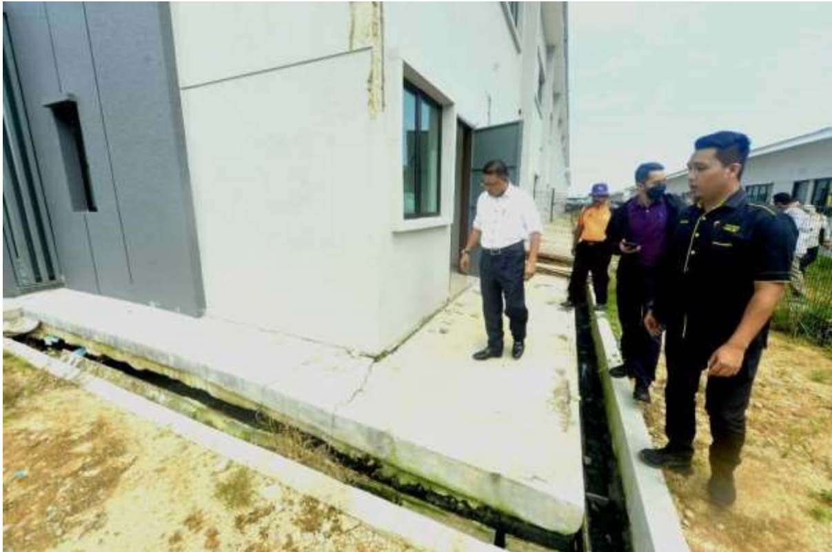
Johari meninjau keretakan struktur binaan rumah di sebuah taman perumahan di Tanjung Lumpur pada Selasa.
