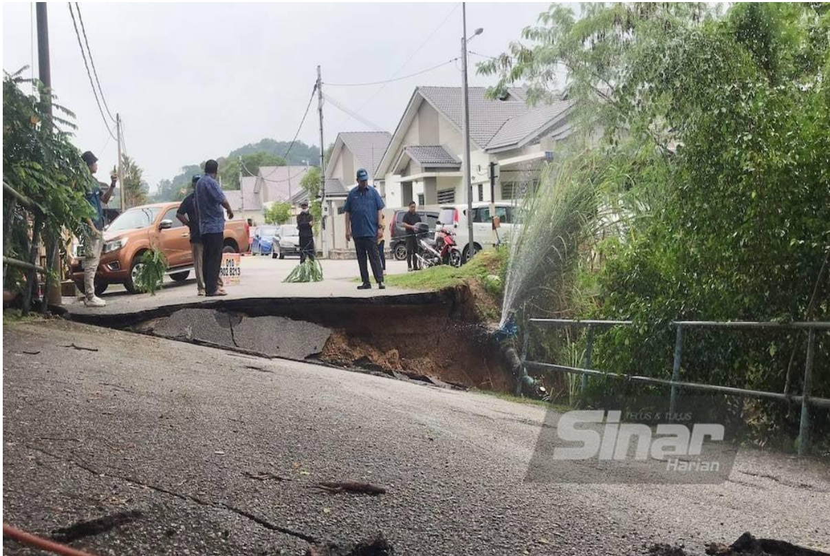
Saifuddin melawat jambatan yang runtuh di Taman Perumahan Bukit Setongkol pada Jumaat.
