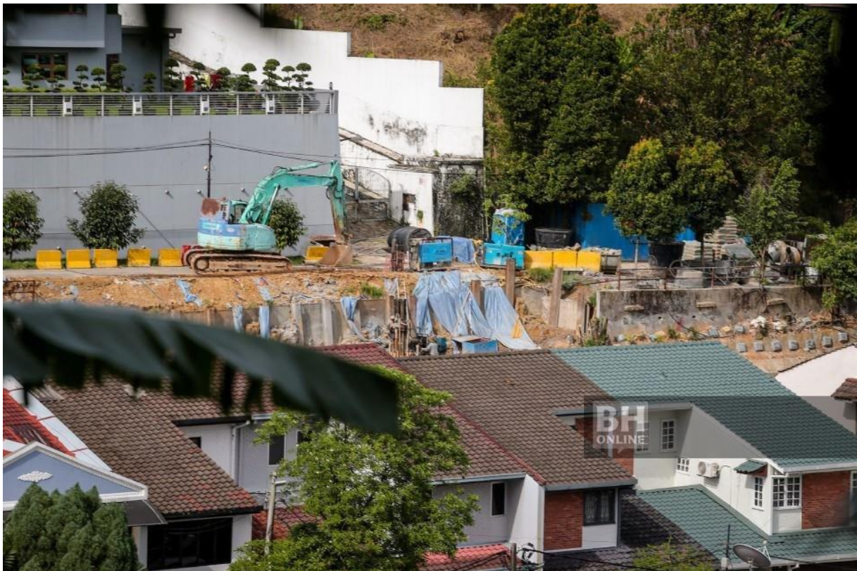
Kesan runtuh di Lingkungan Negeri Sembilan, Bukit Persekutuan yang memberi kesan kepada penduduk Jalan Limau Purut . NSTP/Asyraf Hamzah
