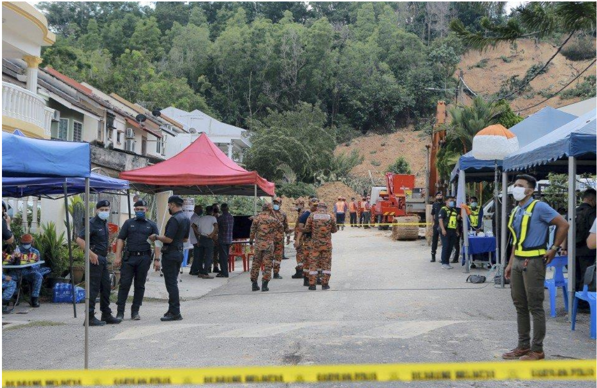
Anggota polis mengawal kawasan kejadian lokasi kejadian tanah runtuh di Taman Bukit Permai 2, Ampang. - Foto NSTP/Asyraf Hamzah
