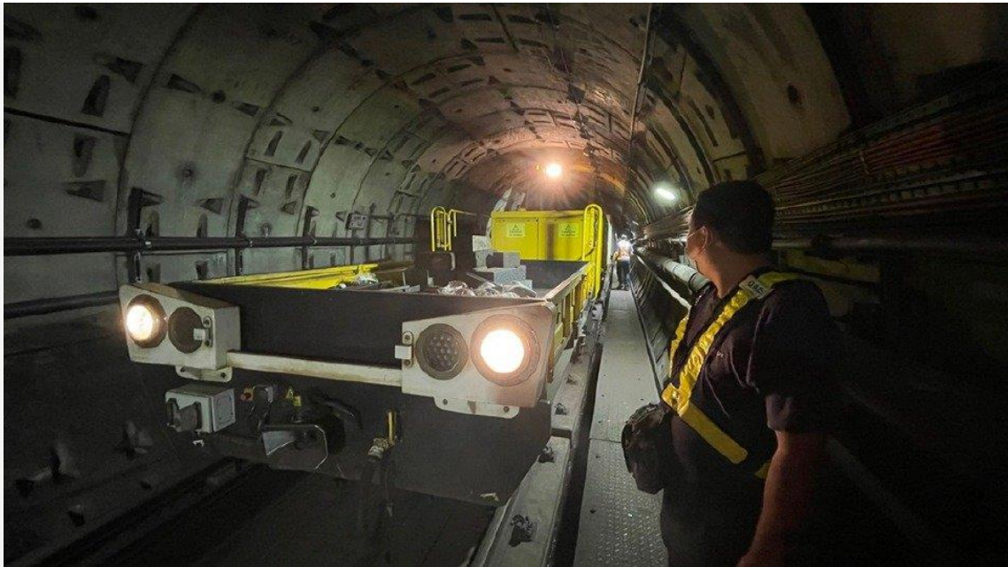
Kerja pemulihan untuk mengeluarkan dua tren Transit Aliran Ringan (LRT), yang bertembung di dalam terowong antara Stesen LRT Kampung Baru dan KLCC Isnin lalu. - Foto ihsan Prasarana
